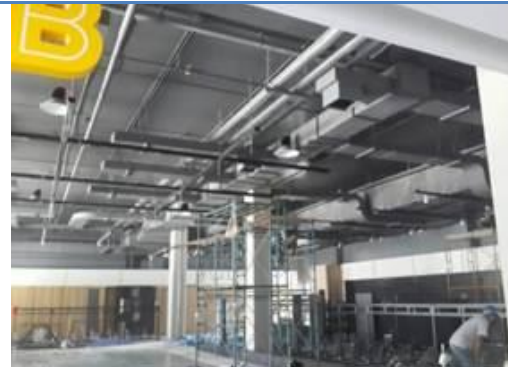
งานระบบท่อส่งลมปรับอากาศ/ระบายอากาศ
