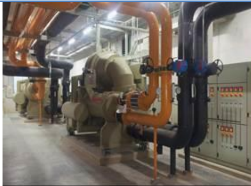
งานระบบปรับอากาศขนาดใหญ่
