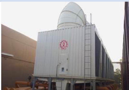
งานระบบเครื่องปรับอากาศขนาดใหญ่
