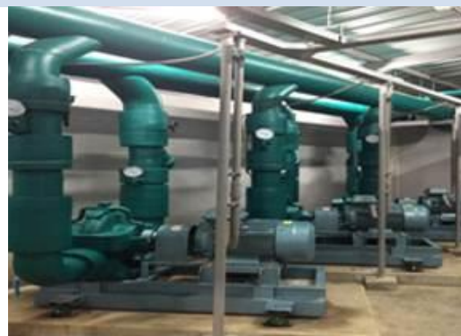
งานระบบเครื่องทำน้ำเย็น
